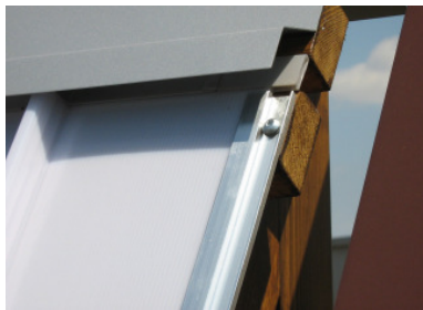
Ausführung mittels Kanteil am First oder bei Anschluss an ein höheres Gebäude
